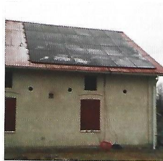
Solceller i öst /väst ladugården. Här östra sidans paneler.
